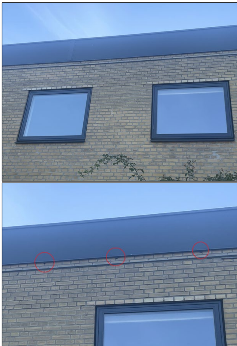
Figur 15.2: Af øverste billede fremgår bygningens østlige facade, som fremstår muret og med topgavl af jernplader. På nederste billede er markeret tre revner med rød ring, hvor murværk møder jern /bilag flagermus/ .
