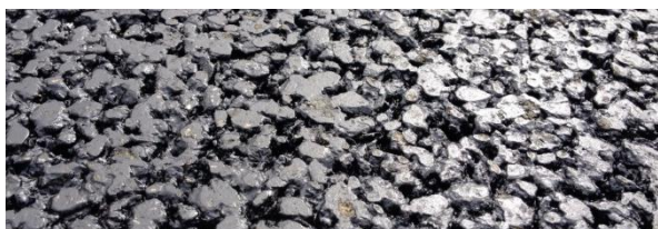
Figur 26. Nærbillede af et nyt og mindre støjende slidlag (teknisk betegnelse: SMA-8). Både den meget jævne og åbne overfladestruktur ses tydeligt. En traditionel belægning (f.eks. SMA-11) har en grovere og mere ujævn struktur.
