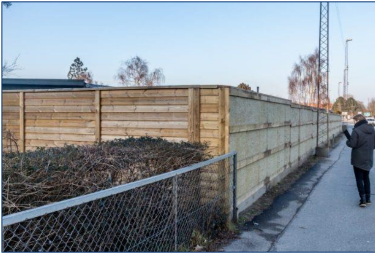
Figur 39. Her har grundejeren bygget sit eget støjhegn og brugt mineraluld på siden mod vejen. Hegnet har formentlig en god støjdempende virkning fordi det er tæt, har en god højde og går op i skel vinkelret på vejen. Mineralulden har ingen betydning for hegnets støjdempende virkning hos grundejeren.
