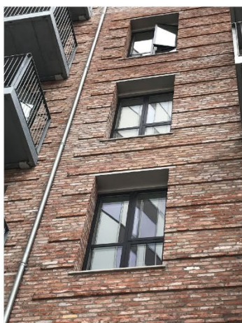
Markering af vindue med betonoverlægger og sålbænk Århusgadekvarteret, Nordhavn (Henning Larsen Tegnesteue)
