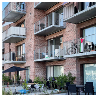
Eksempel på vertikal forskydning af facaden.
