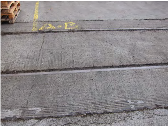
Jernbanespor og gule bemalinger på belægningen.
