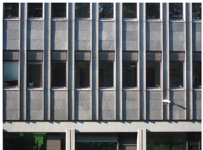
Levende facader trods det repetitive modulsystem – lodrette linjer giver modspil til de vandrette, og de smalle profiler giver facaden relief og spil mellem lys og skygge (hovedbygningen).
