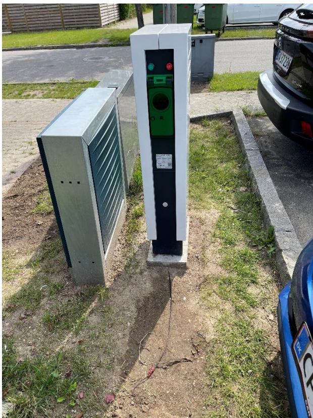
Ladestander ved Glentehusene i Albertslund.
