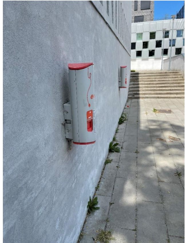
Ladestander ved Gate 21 i Albertslund Kommune.
