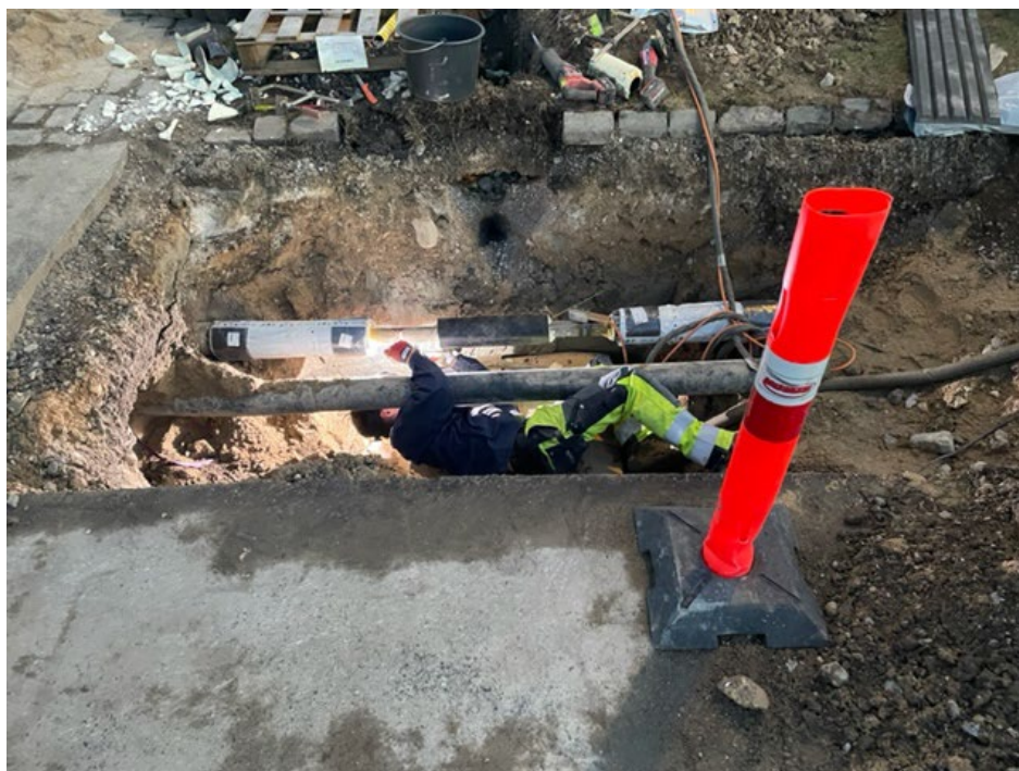
Brud på Skærager, hvor en jordraket har ramt fjernvarmeledningen ifm. fibernet arbejde.
