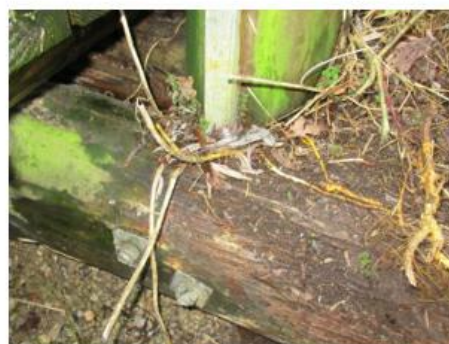
Kraftigt råd i tværbjælker
