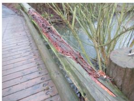
Kraftigt råd i rækværk
