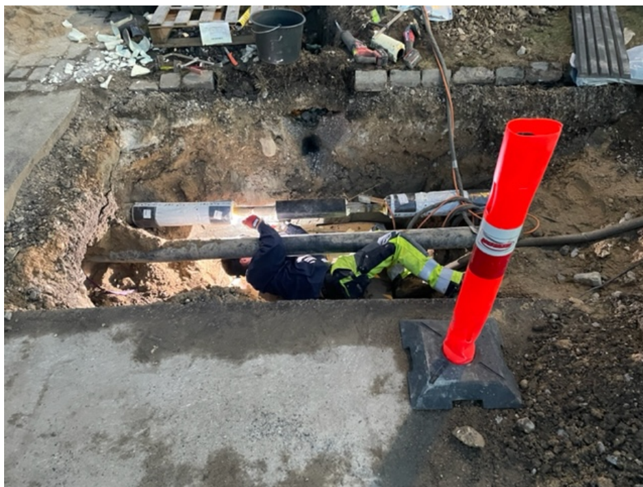
Brud på Skærager, hvor en jordraket har ramt fjernvarmeledningen ifm. fibernet arbejde.
