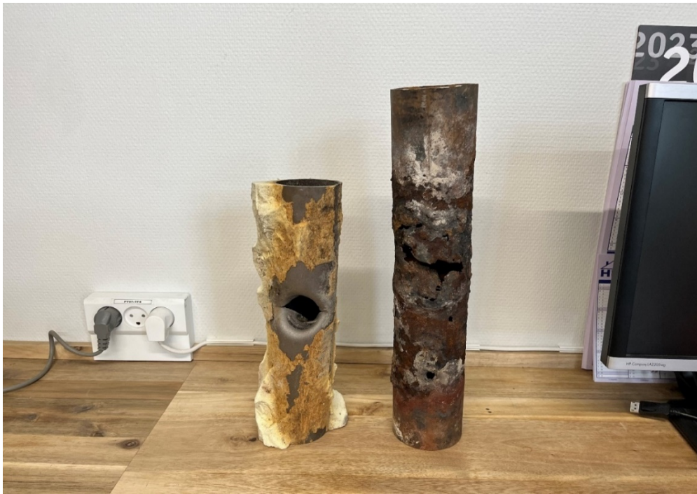
2 eksempler på brud. Til venstre: Brud grundet jordraket. Til højre: Brud grundet tæring af røret lokalt, kappen kan være skadet af et jordbor for 20 år siden ifm. opsætning af hegn.
