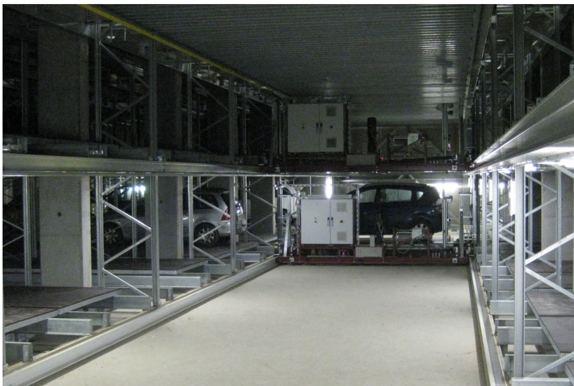
Figur 3.7 Eksempel på et fuldautomatisk parkeringsanlæg.
