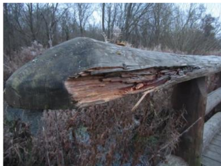
Kraftigt råd i rækværk
