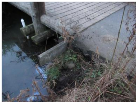
Erosion og manglende sidehold på vejkasse
