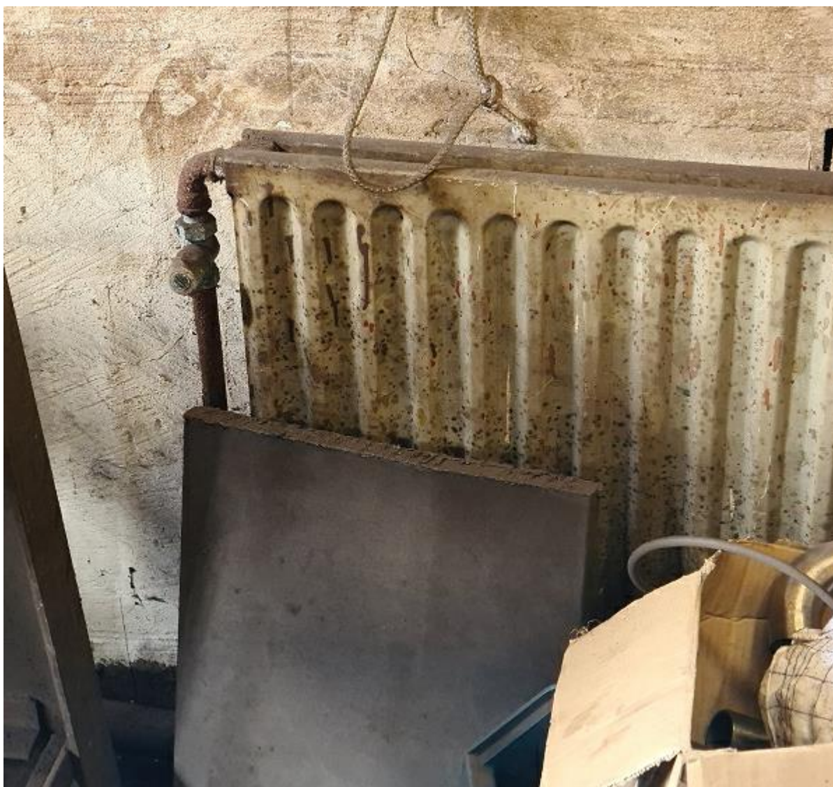
Radiator i industrien, med manuel radiatorventil.
