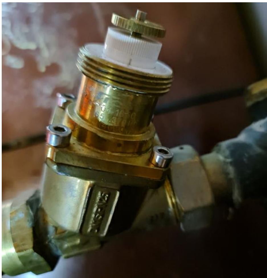
Motorventil til regulering af radiator kredsen, som maksimalt kan lukke 350 l/h gennem anlægget. Potentialet fra nettet er 700 det dobbelte.
