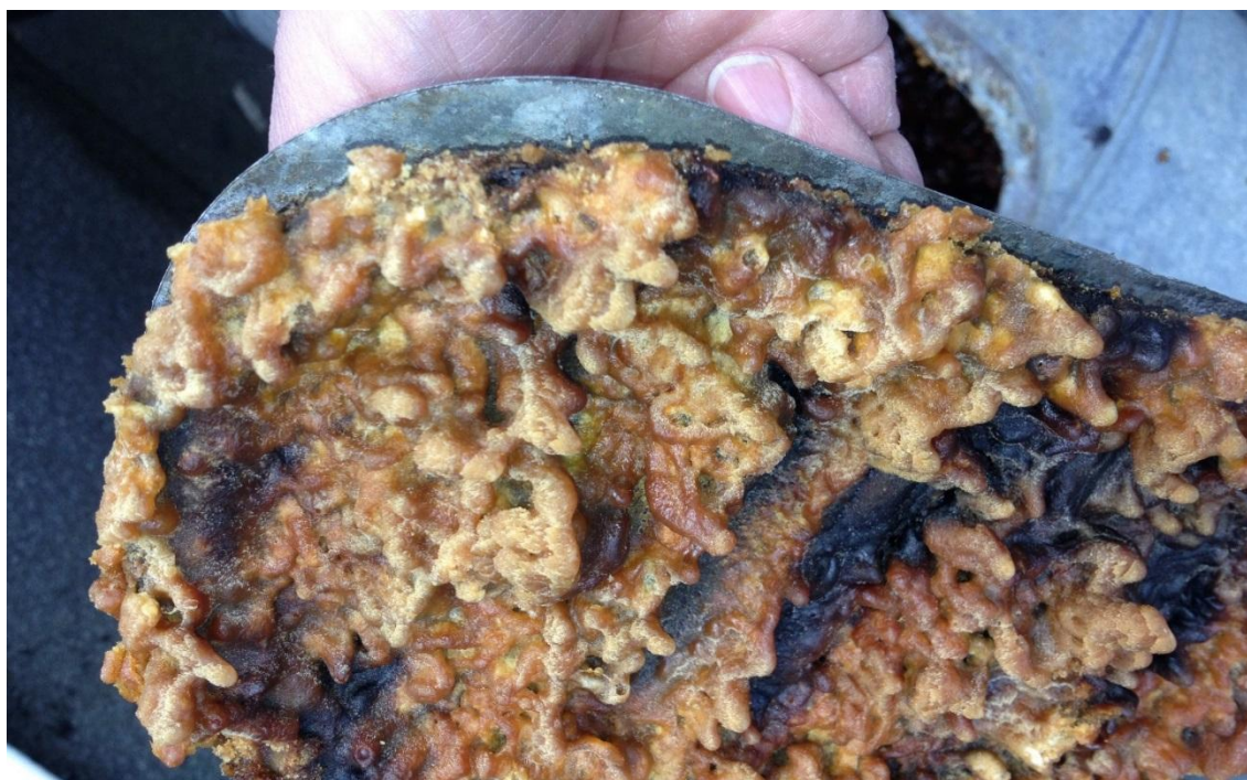
Figur 1. Renselem i udsugningskanal på taget fra restaurant med dårligt fungerende fedtfiltre
