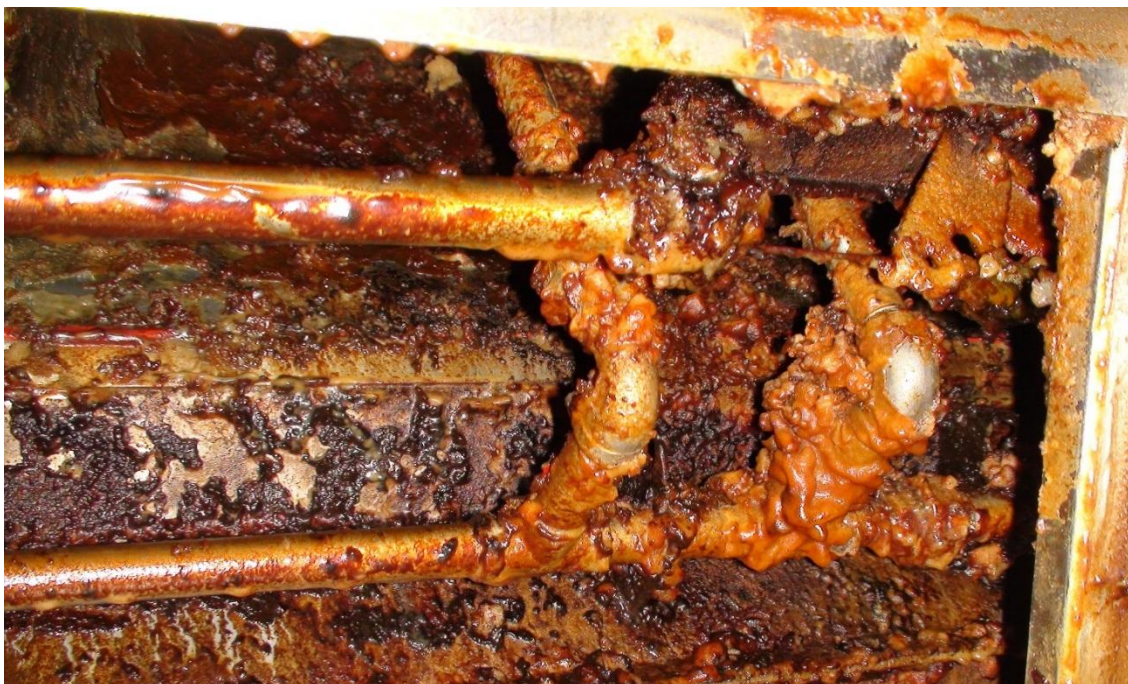
Figur 2. Indvendigt i emhætte på restaurant med dårligt fungerende fedtfiltre
