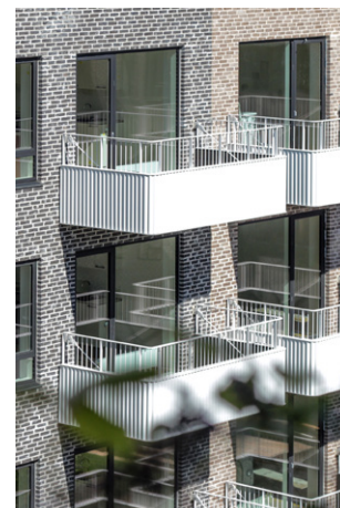
Eksempel på altanværn udført i kombination af lodrette balustre og lukkede plademateriale. Den lukkede del er her udført i malet sinusplade.
