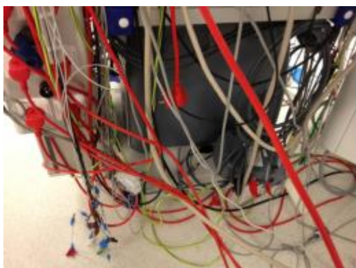
Kabler og ledninger kan udgøre et rengøringsproblem, hvis de ikke samles i kanaler eller kabelbakker.
