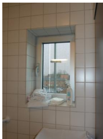
Eksempel på niche, som indbyder til at efterlade ting, der vanskeliggør rengøring. Undgå nicher af denne type.
