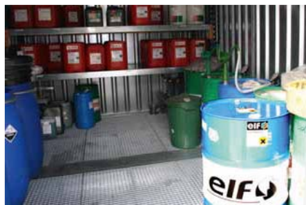
Stor container med opkant, rist og sikret bund.
