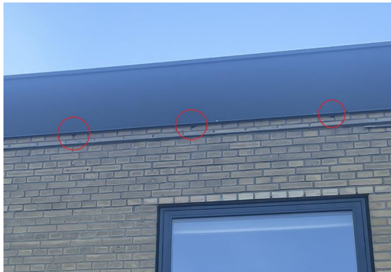
Figur 1: Bygningens østlige facade, som fremstår muret og med topgavl af jernplader. På billedet er markeret 3 revner hvor murværk møder jern.
