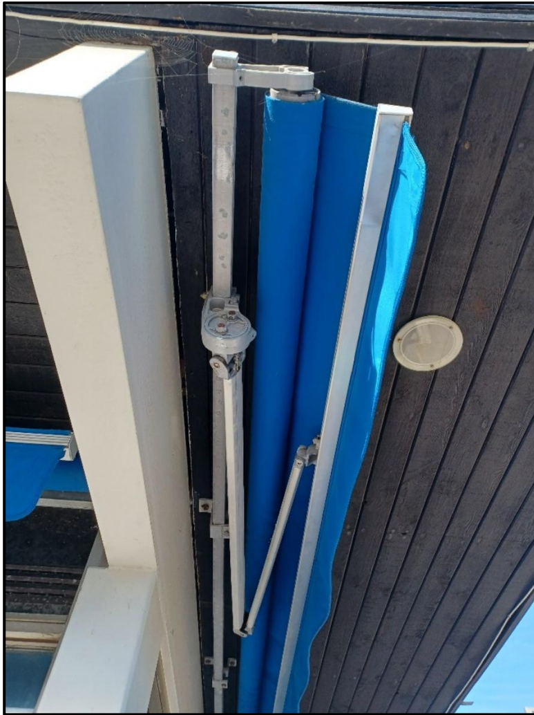
Figur 5: Sprækker i udhængets konstruktion. © DMR A/S
