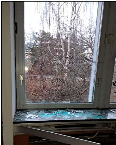
Figur 11: Vinduer smadret, giver god indflyvning og adgang for flagermus.
