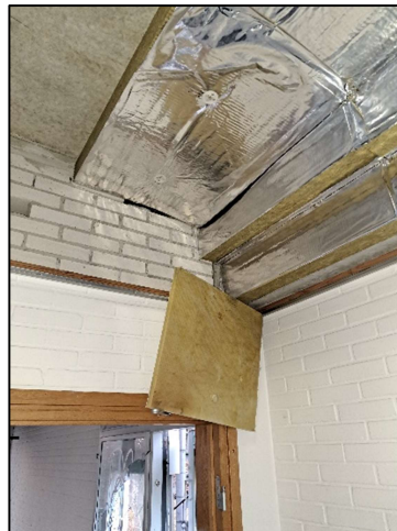
Figur 12: Blotlagt isolering i loftsstrukturene.
