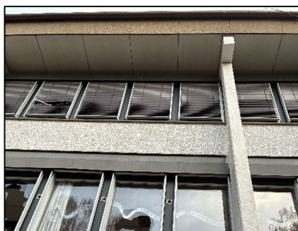
Figur 6: Kig op under udhæng, ingen utætheder men ukendt konstruktion.
