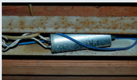
Kondensator i gammelt lysstofrørarmatur.
