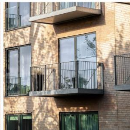
Altan, galvaniseret stål, balusterværn
